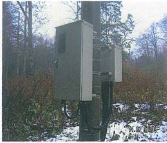
屋外制御機器取付例
