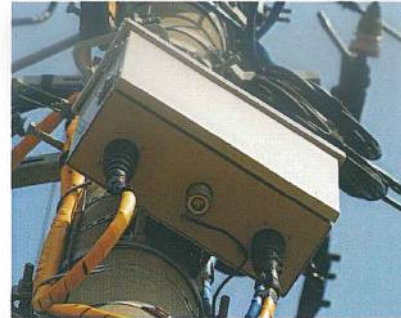
電柱に取り付けられた制御盤
