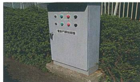
自動開閉扉用制御盤
