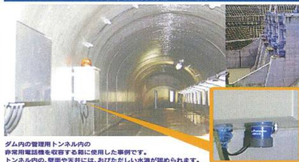
トンネル内機器
